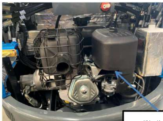
Ubicación del filtro de aire
