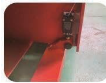
Figura 2 (Interruptor de activación de protección de foso)
